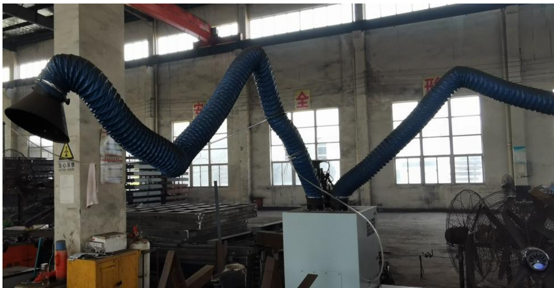
电焊区焊烟吸尘罩
